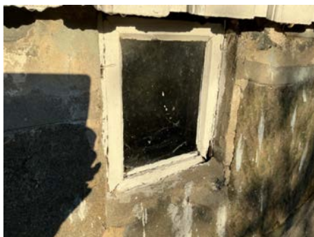
Eldre vindu kjeller, råte i karm etc.
