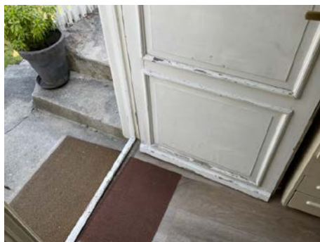
Inngangsdør. Værslitasje og utett mellom karm og dørblad.
