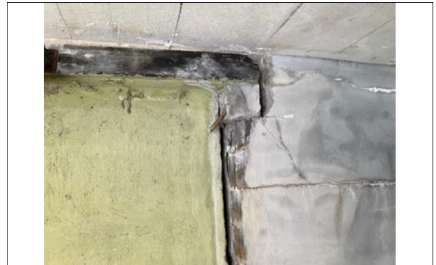
Setningssprekker i garasje
