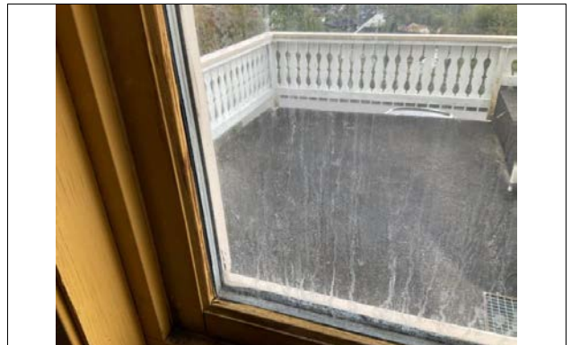
Vinduer har punkterte isolerglass
