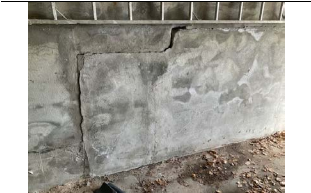
Setningssprekker i garasje
