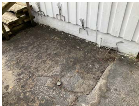
Nedgravd tank under støpt terrasse
