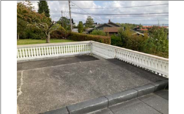
Rekkverk har for lav høyde. Bør endres på område som er forhøyet med tanke på fallfare
