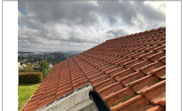
Takflate. Normal slitasje ut fra alder
