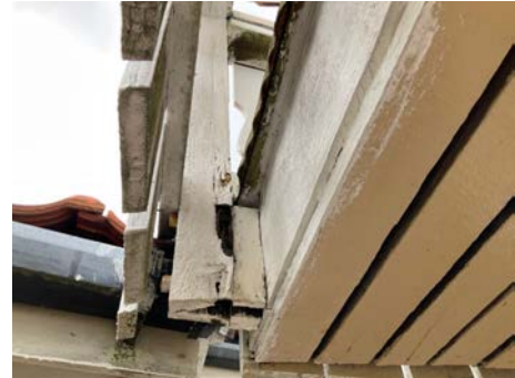
Synlig råteskade på rekkverk
