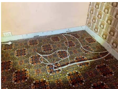
Løs ledning uten endestykke
