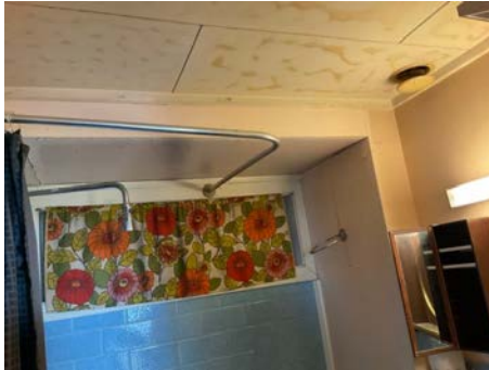
Høy alder og slitasje
