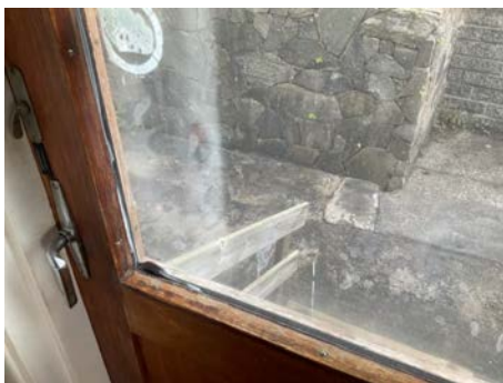
Stuedør med punktert isolerglass
