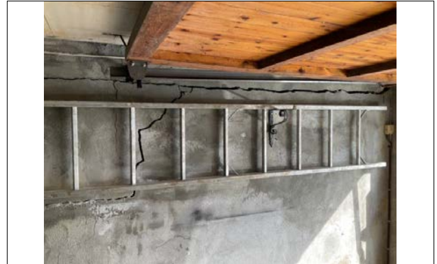
Setningssprekker i garasje
