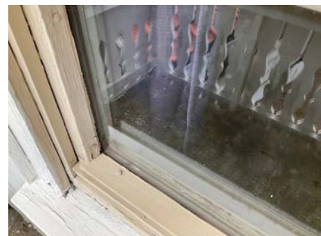
Eksempel på punktert isolerglass
