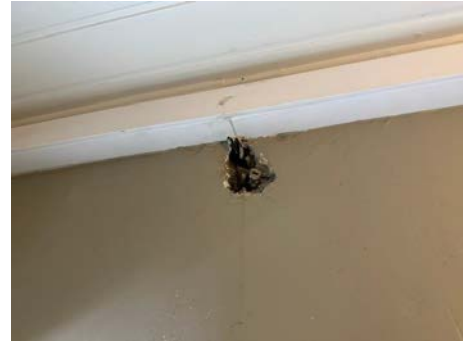
Hull i vegg og gamle strømledninger.
