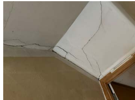
Store sprekker i trapperom til loft.
