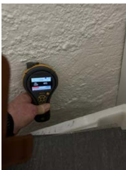
Høye fuktverdier i kjellervegg mot vest(gammel drenering)
