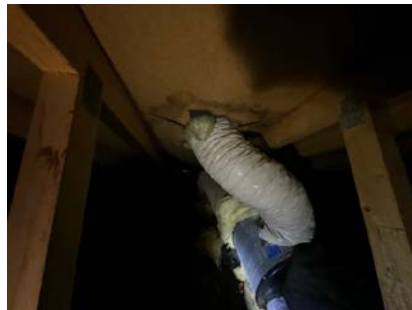
Fuktskjolder rundt luftelyre.
