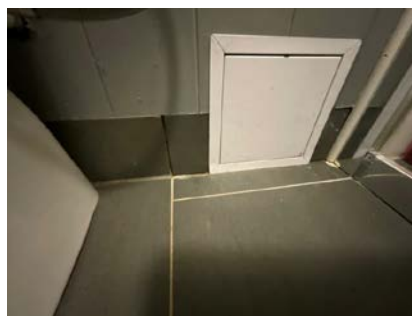
Manglende fuge ved inspeksjonssluke.
