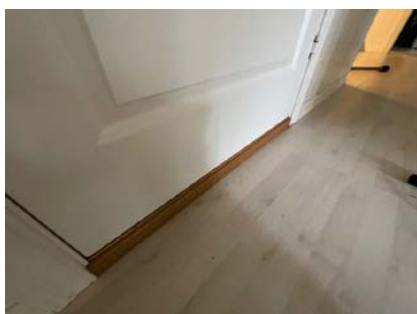
Manglende tilluftspalte i dør.
