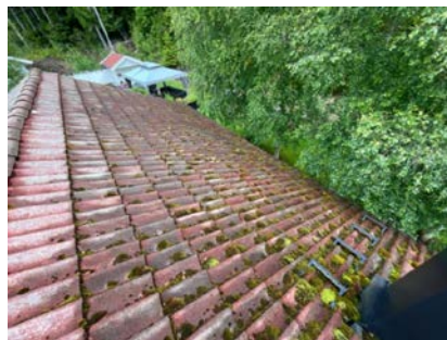
En del mosedannelse på takstein.
