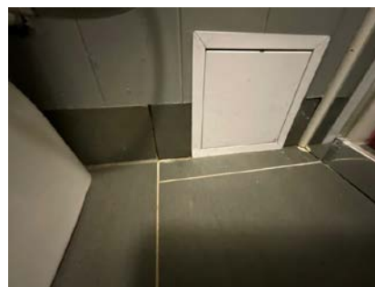
Manglende fuge ved inspeksjonssluke.
