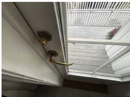
Noe løs vrider på balkongdør
