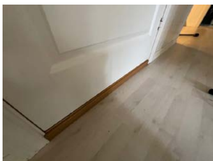
Manglende tilluftspalte i dør.
