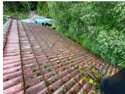
En del mosedannelse på takstein.
