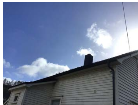
Mangler takrenne over inngangspartiet
