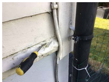
Skader i bunn stokk
