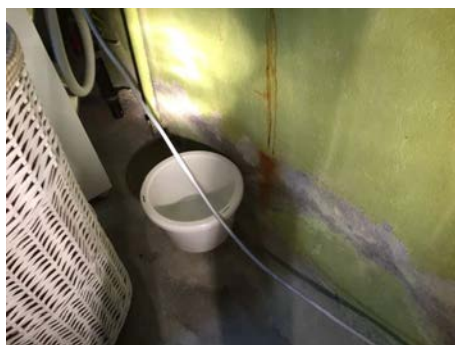
Fukt langs gulv/vegger
