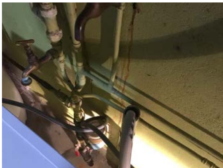
Eldre kobber rør med vannmåler plassert på vaskerom
