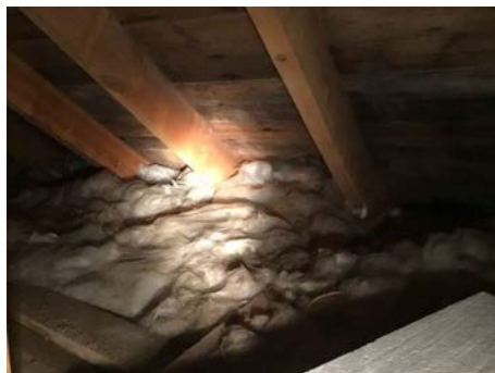
Ikke etablert lufting i skråtak
