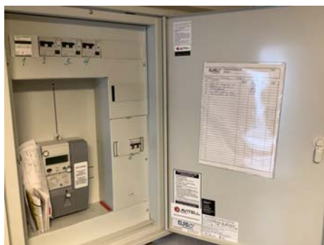
Sikringsskap i kjeller.
