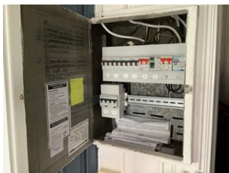
Sikringsskap i 1. etasje.
