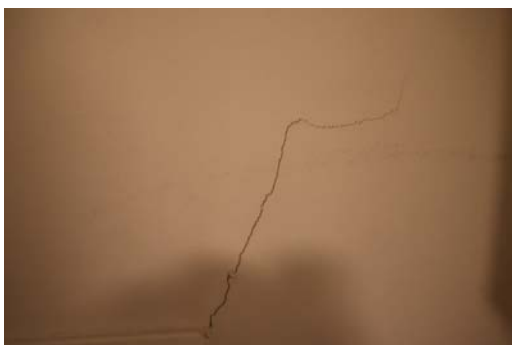
Riss på veggen i boden.
