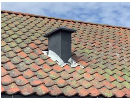
Mangelfull reparasjon av luftehatt, utbedringer trengs.
