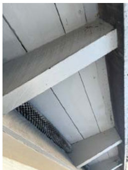
Luftespalte med sikring mot fugler/mus
