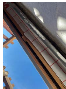
Utlektet og trolig etterisolert. Synlig musetetting og lufting (fasade mot vest)
