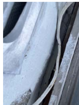
Lite/ingen lufting bak kledning på fasade mot øst
