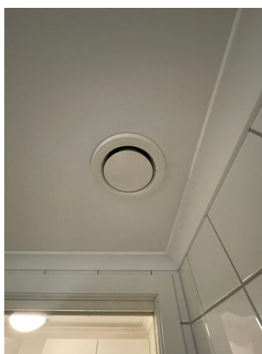
Ventilasjonsventil i himling.
