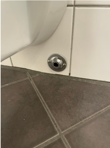
Drenering for synliggjøring av lekkasjevann fra innebygget sisterne.
