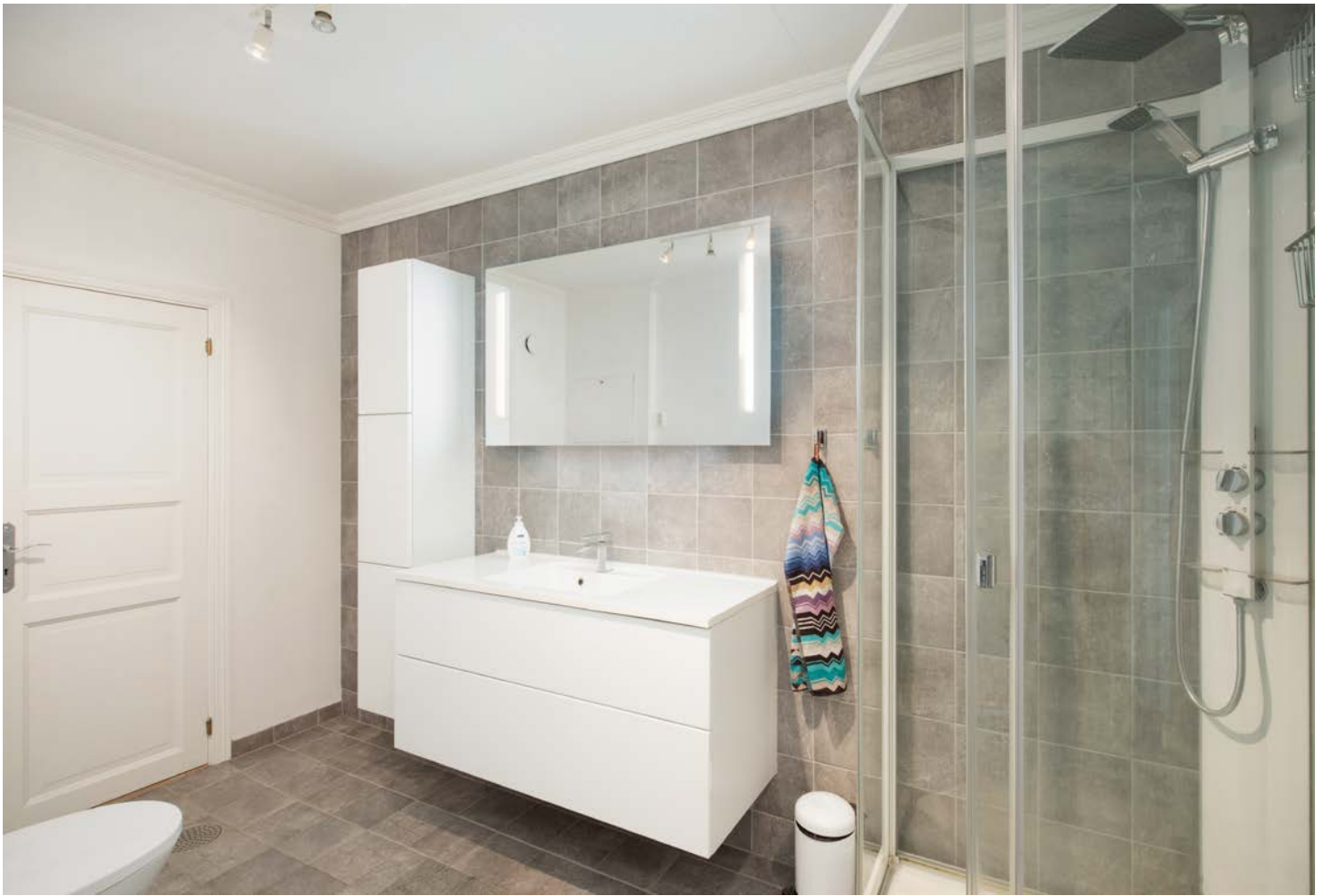
Bad med varmekabler i golv
