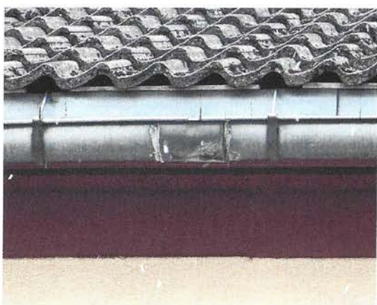
Betong takstein og takrenne fra byggetiden.
