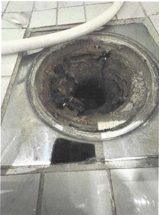
Sluk i gulv ikke synlig membran.
