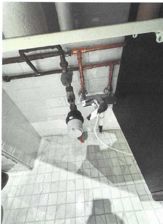
Røropplegg for vannrør til vasken.
