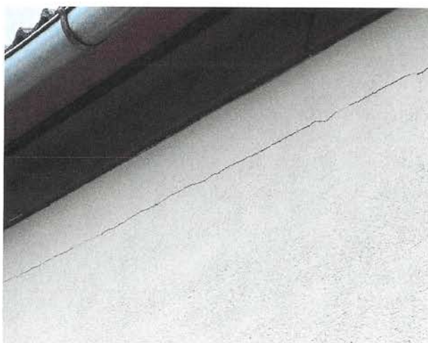
Eksempler på sprekk i leca. Mur mot nabo.
