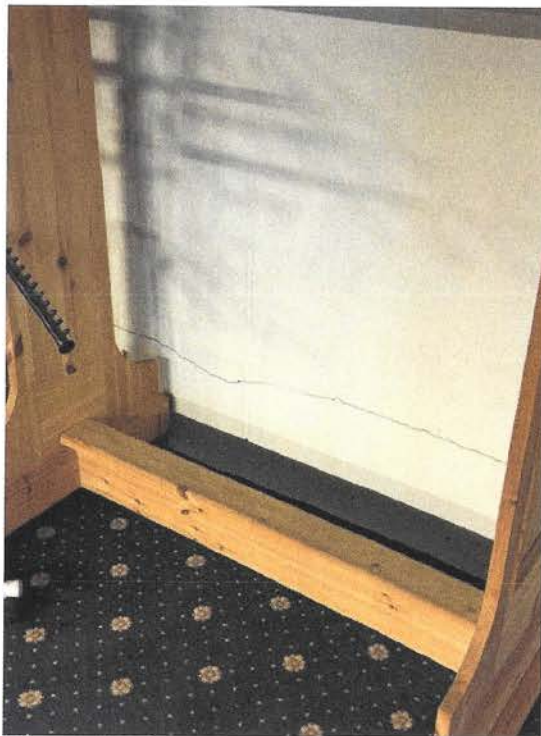
Eksempel på sprekk i leca mur inne.
