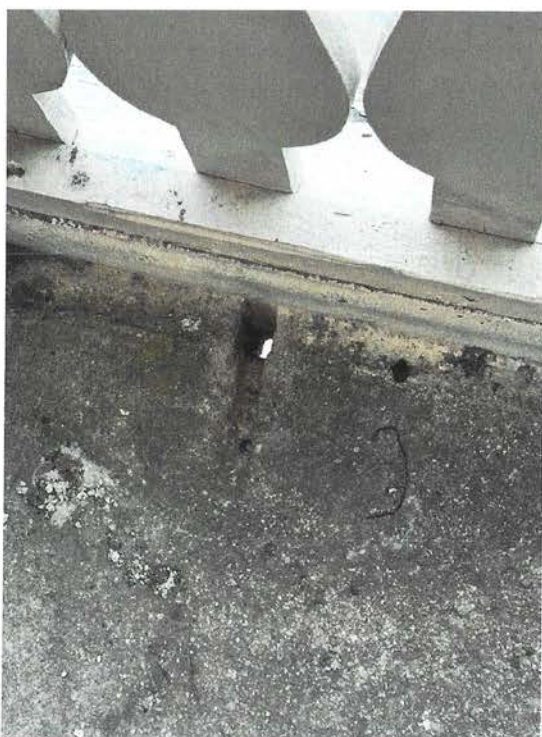
Dreneringshull/avrenning fra veranda.
