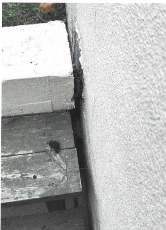
Sprekk mellom mur somnabo har satt opp og grunnmuren.
