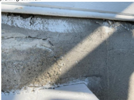
Riss/sprekk i grunnmur.
