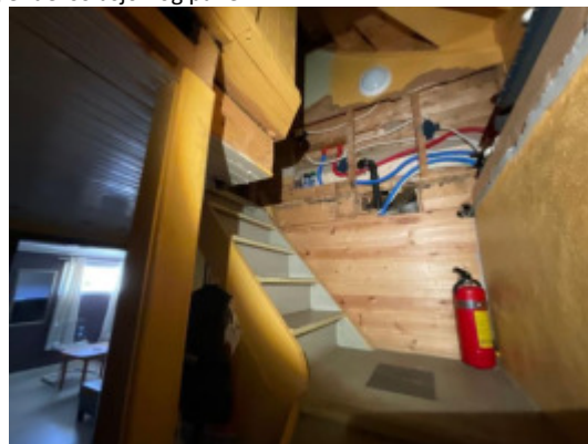
Manglende isolasjon og plater på vegg mot kjøkken
