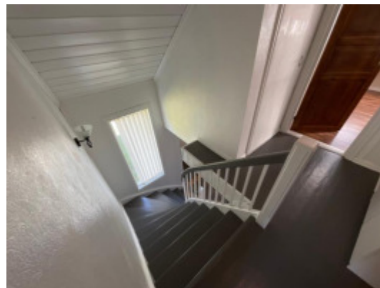
Manglende håndløper og rekkverk
