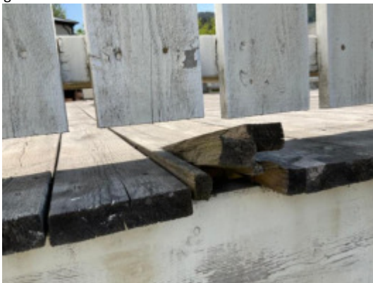
Skadet terrassebord på altan
