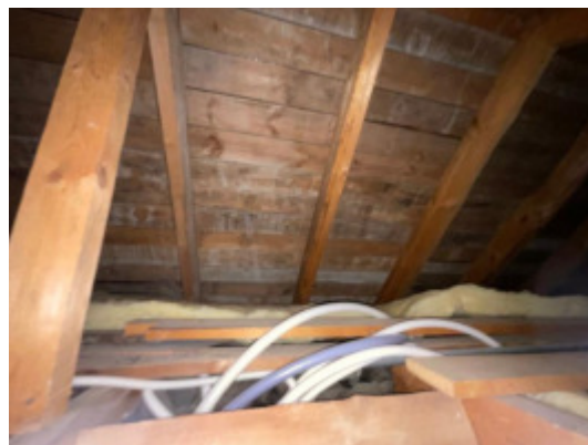
Løse kabler på loft
