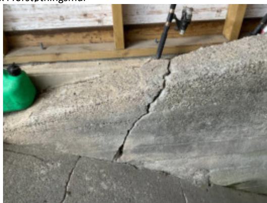
Sprekk i forstøtningsmur
