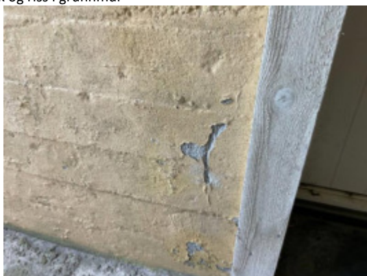
Riss/sprekk i grunnmur.
