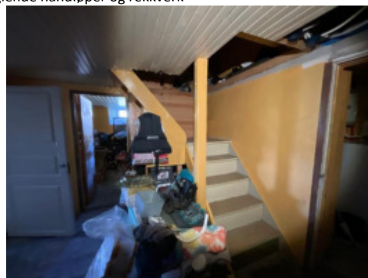
Manglende håndløper og rekkverk
