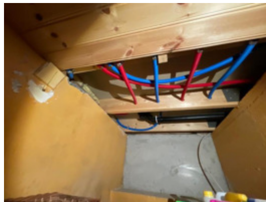
Manglende isolasjon og panel
