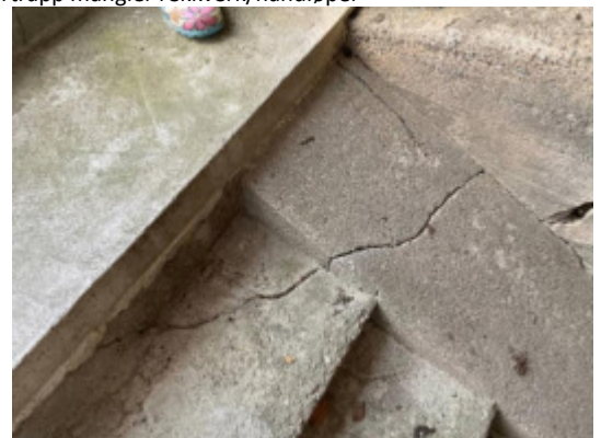
Sprekker i kjellertrapp
