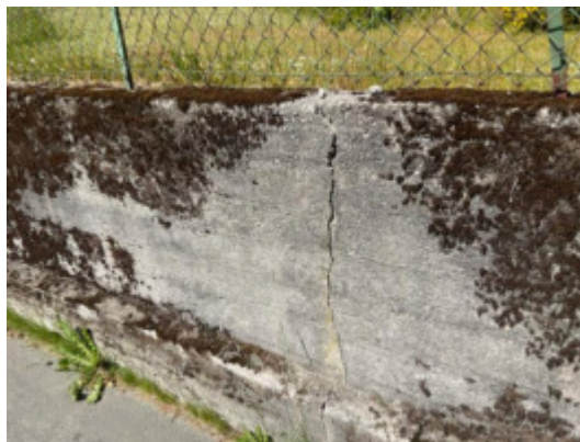
Sprekk i forstøtningsmur
