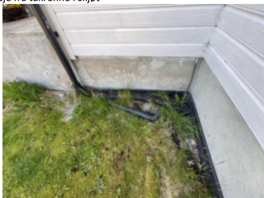
Manglende bortledning av takvann
