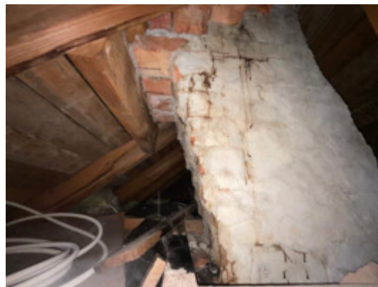
Sotvann fra pipestokk
