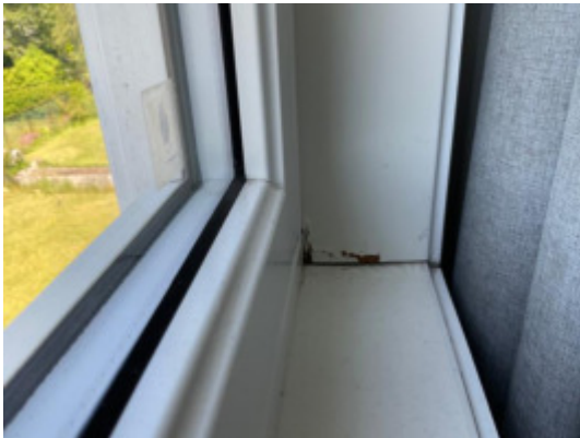
Skade i foring loftsvindu
