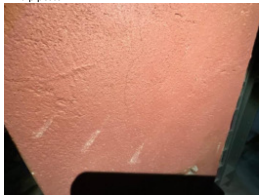
Riss i pipestokk i kjeller
