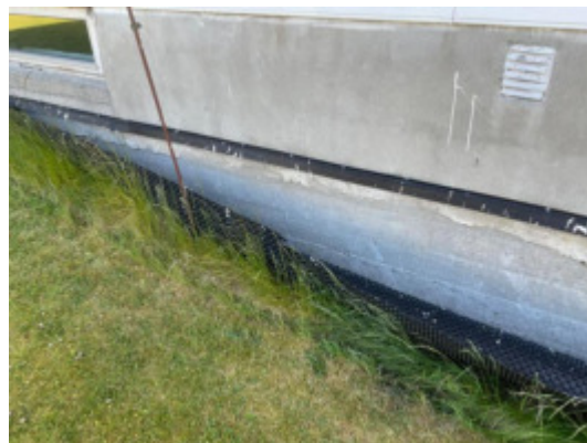
Grunnmursplasten har løsnet fra klemlisten
