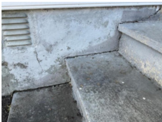
Sprekk og riss i grunnmur
