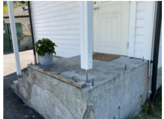
Manglende rekkverk/håndløper ved inngangsparti
