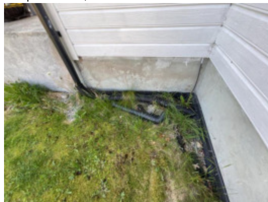
Takvann er ledet mot grunnmur
