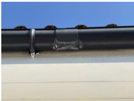
Lekkasje fra takrenne i skjøt
