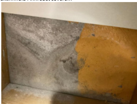
Salt/kalk utslag betongvegger under terreng
