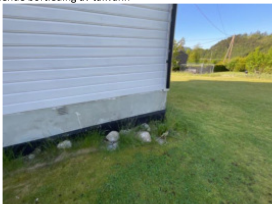
Manglende bortledning av takvann
