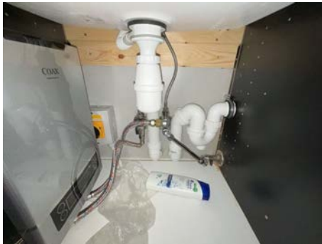
Utsnitt avløpsrør i plast.
