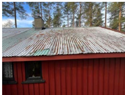
Hull i enkelte takplater.
