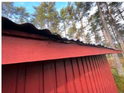
Noe synlig råte på nederste takbord.
