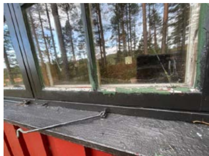
Noe oppsprekking av fuge rundt glass.
