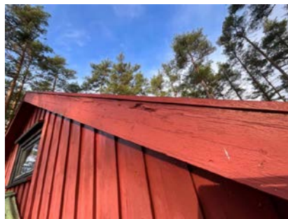
Noe slitasje på vindski.
