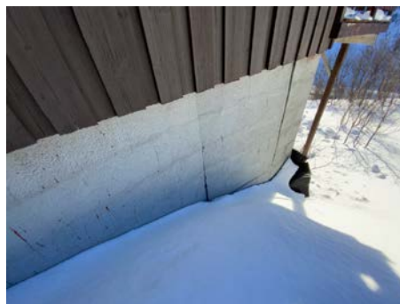
Vegg mellom pilarer med større avvik!!
