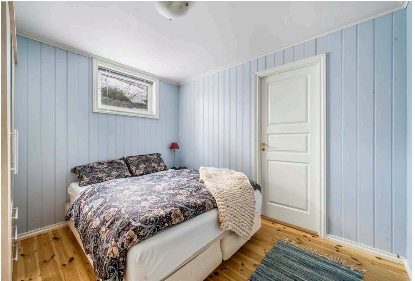
Bod som er innredet til soverom, rom ikke godkjent til soverom iflg tegninger.
