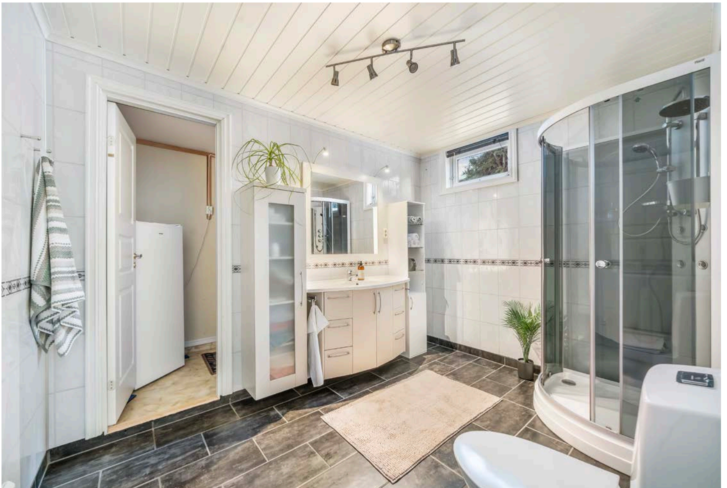
Bad med baderomsplater på vegg og fliser på gulv. Varmekabler i gulv. Badet er innredet med baderomsinnredning, toalett og dusjkabinett.
