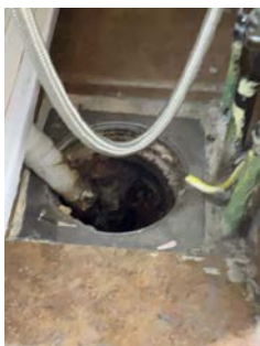
Støpejernssluk med rustsvekkelser og manglende tettesjikt.
