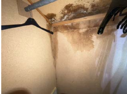
Innvendig fuktskade i skap / kott.
