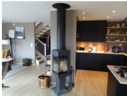
Ildsted tilsluttet stålpipen
