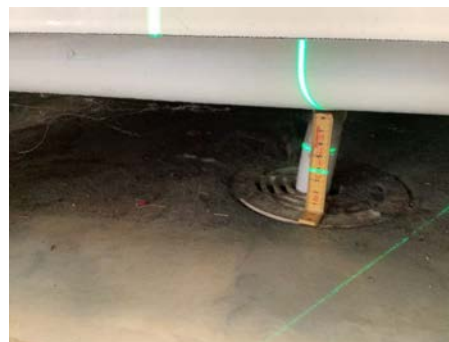
Måling til sluk under kabinett
