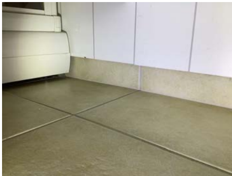
Plater er ikke montert på sokkellist.
