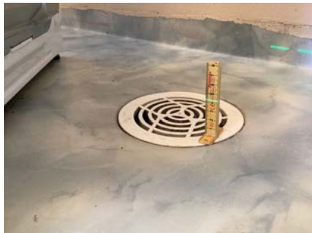
Måling til sluk ved kabinett
