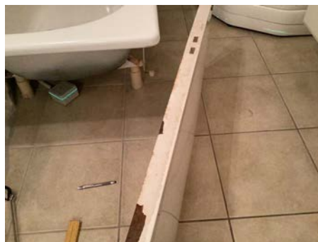
Noe rust på emalje
