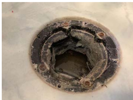
Sluk under vaskemaskin
