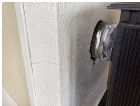
Sprekk i brannmur
