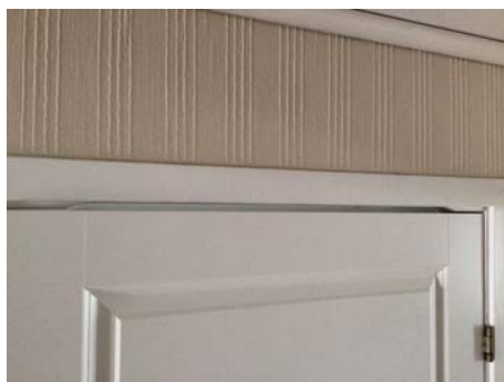
Spalte ved dør
