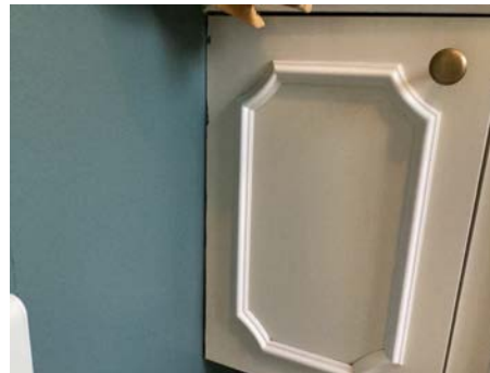
Bruksslitasje på innredning
