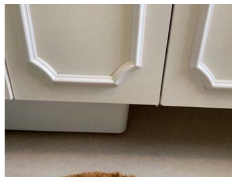
Bruksslitasje på innredning
