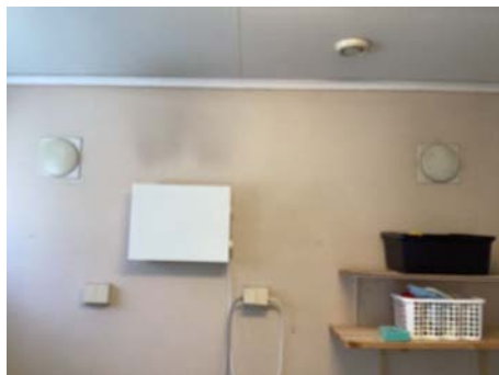
Tilluft fra ventiler i vegg.
