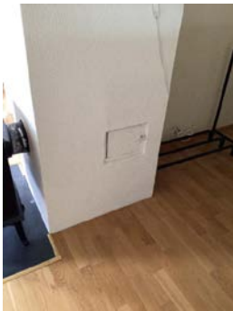
Mangler plate på gulv under luke.
