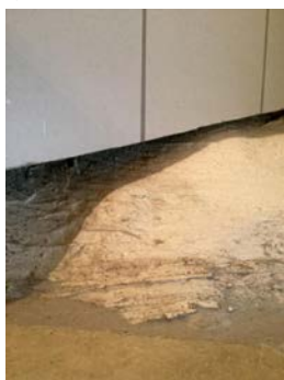
Deler av fjell er synlig i våtrommet
