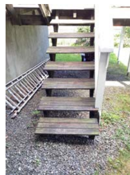
Trapp mangler rekkverk på en side.
