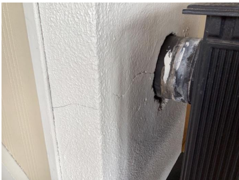
Sprekk i brannmur
