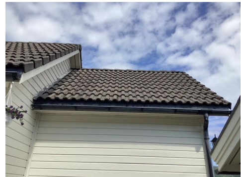
Det er ikke snøfangere på taket
