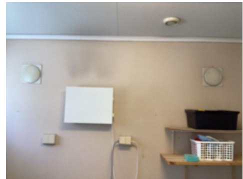
Tilluft fra ventiler i vegg.
