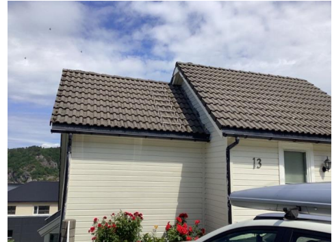
Det er ikke snøfangere på taket
