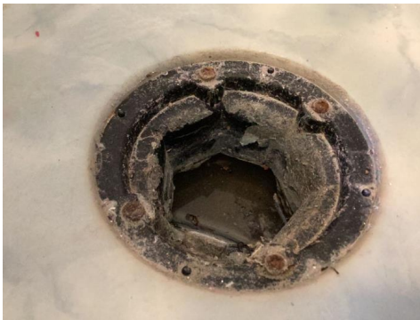
Sluk under vaskemaskin
