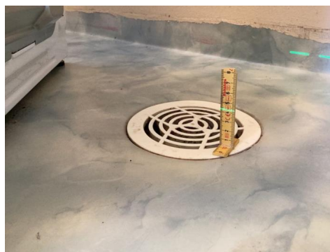
Måling til sluk ved kabinett
