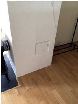
Mangler plate på gulv under luke.
