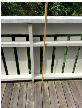
Rekkverk er lavere enn dagens krav
