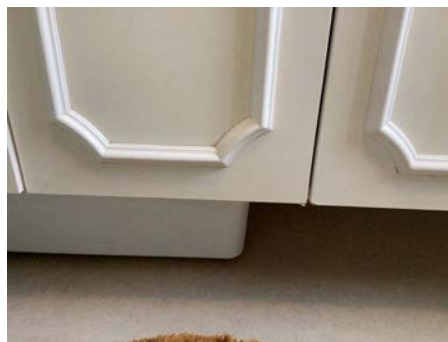
Bruksslitasje på innredning
