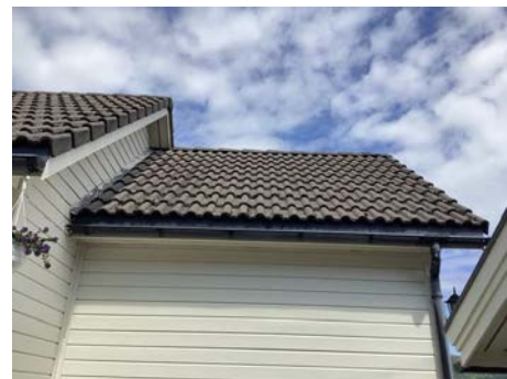
Det er ikke snøfangere på taket
