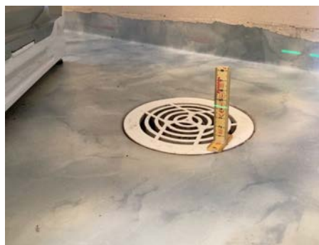
Måling til sluk ved kabinett
