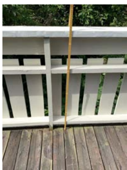
Rekkverk er lavere enn dagens krav
