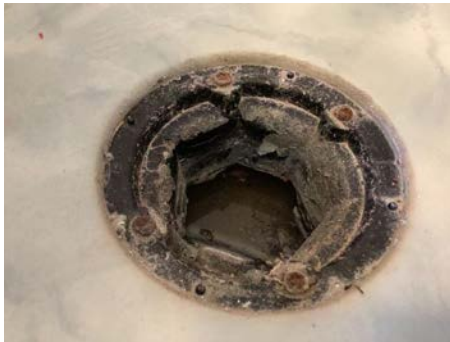
Sluk under vaskemaskin
