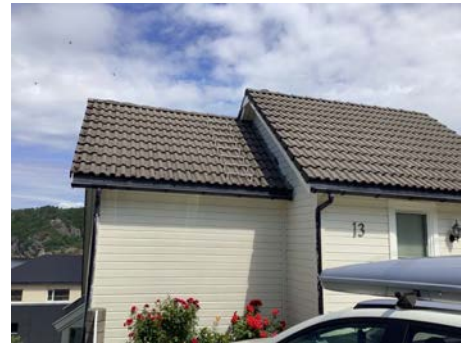
Det er ikke snøfangere på taket
