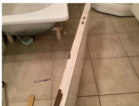
Noe rust på emalje
