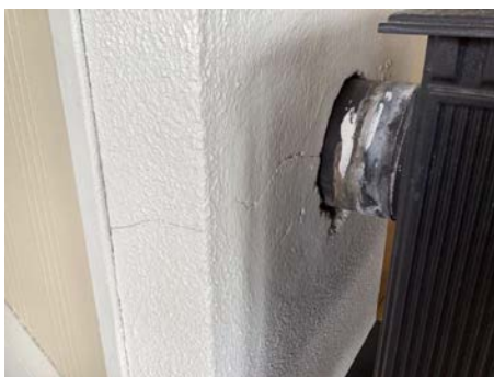
Sprekk i brannmur
