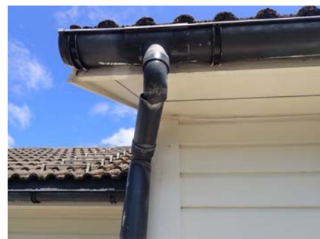
Utett i overgang på nedløp.
