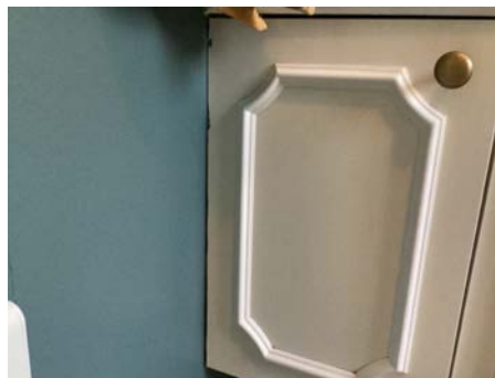
Bruksslitasje på innredning
