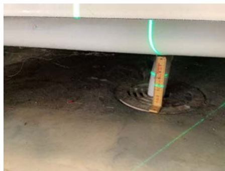
Måling til sluk under kabinett
