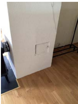
Mangler plate på gulv under luke.
