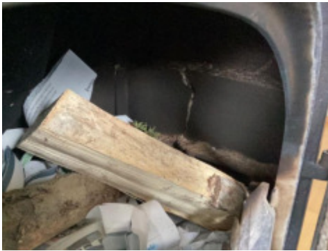
Sprekk på plate i ovn.
