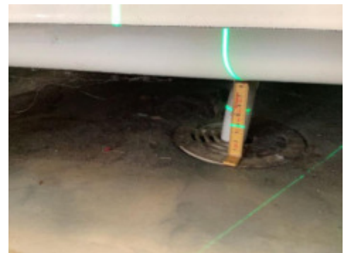
Måling til sluk under kabinett
