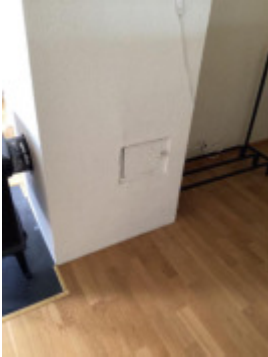
Mangler plate på gulv under luke.
