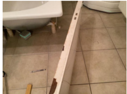
Noe rust på emalje
