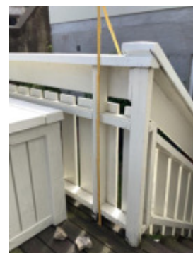
Rekkverk er lavere en dagens krav
