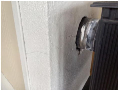
Sprekk i brannmur
