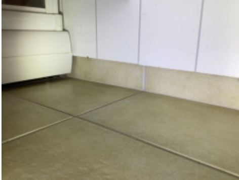
Plater er ikke montert på sokkellist.
