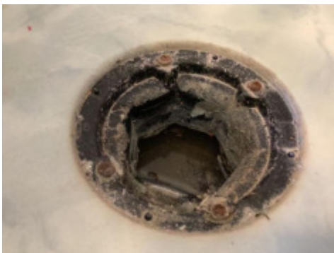
Sluk under vaskemaskin
