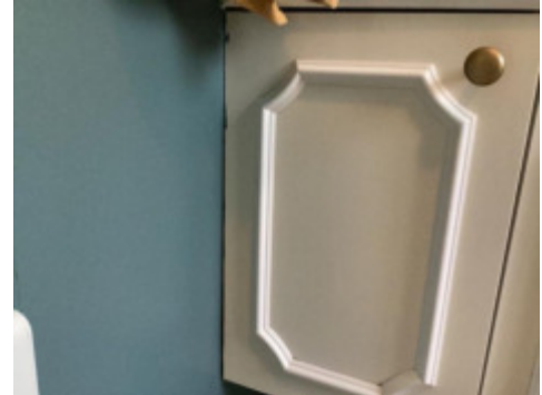
Bruksslitasje på innredning
