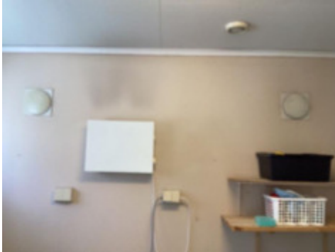
Tilluft fra ventiler i vegg.
