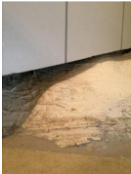
Deler av fjell er synlig i våtrommet
