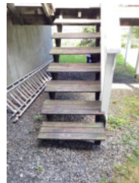
Trapp mangler rekkverk på en side.
