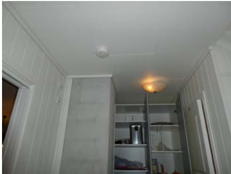
Røkvarsler i gang 1.etasje
