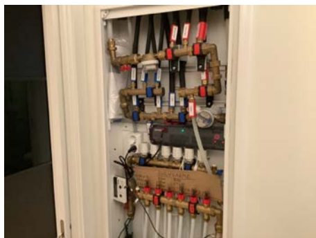
Fordelerskap for røropplegget og vannbåren varme.
