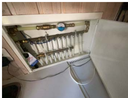
Skap til rør i rør system, her er også stoppekran til vann.
