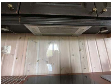
Montert avtrekk over steketopp.
