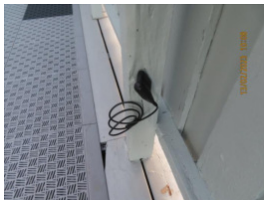
Råteskade i tresøyle på overbygget del av veranda, utenfor kjøkken
