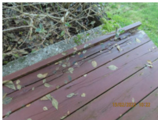
Råte i terrassebord på treplating utenfor underetg.
