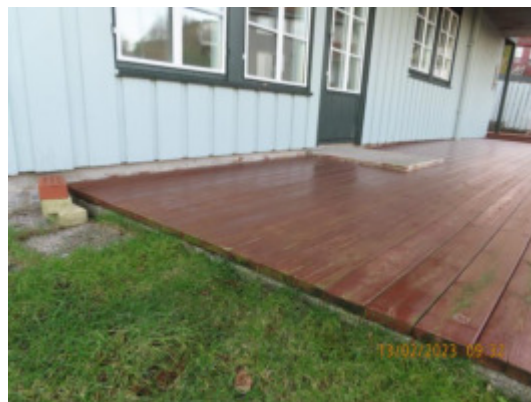
Sig/skjevheter i treplating utenfor underetg.
