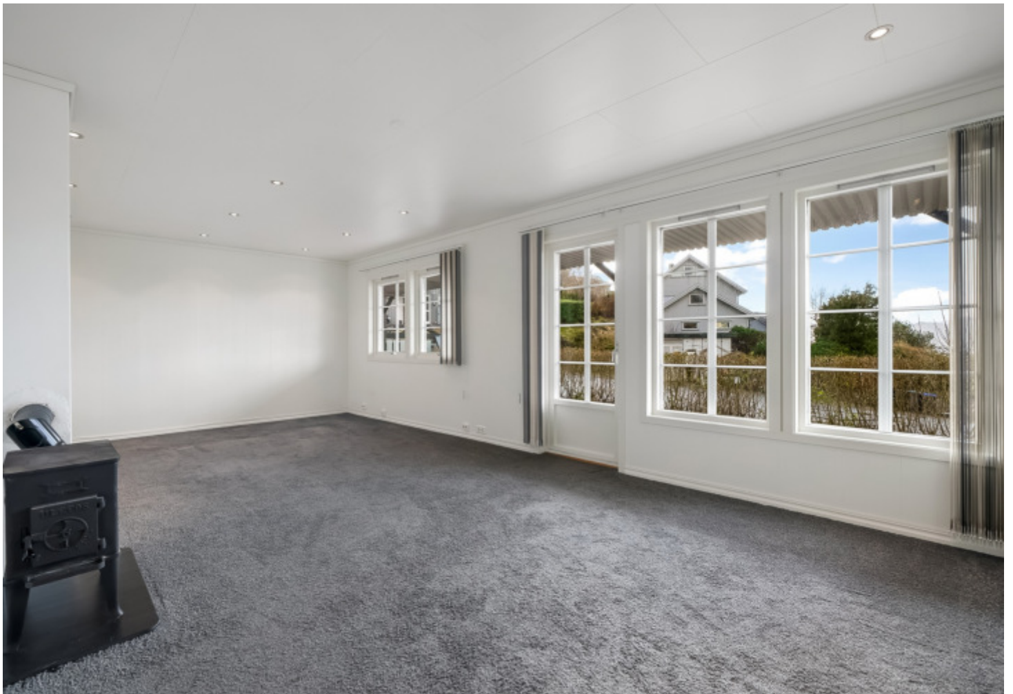
Rom i underetasjen innredet som kjellerstue, ikke godkjent til dette bruket.
