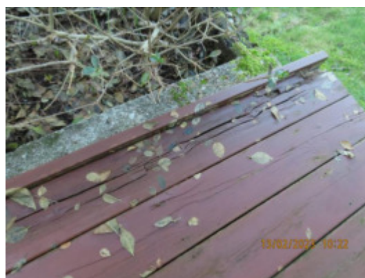
Råte i terrassebord på treplating utenfor underetg.
