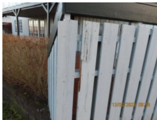
Råteskade i hagegjerde
