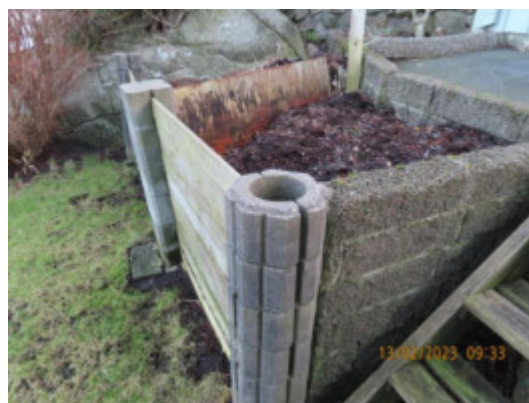
Skjevheter i søyler av betongblokker
