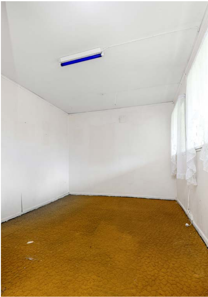
Kjellerrom, brukt til soverom. (Ikke godkjent til varig opphold)
