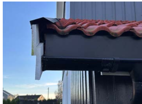
Vindskibeslag montert for lavt
