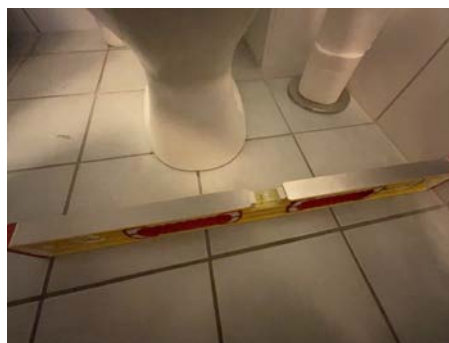
Mindre avvik på gulv ved toalett.
