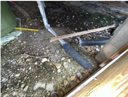
Utvendig avløpsrør i plast.
