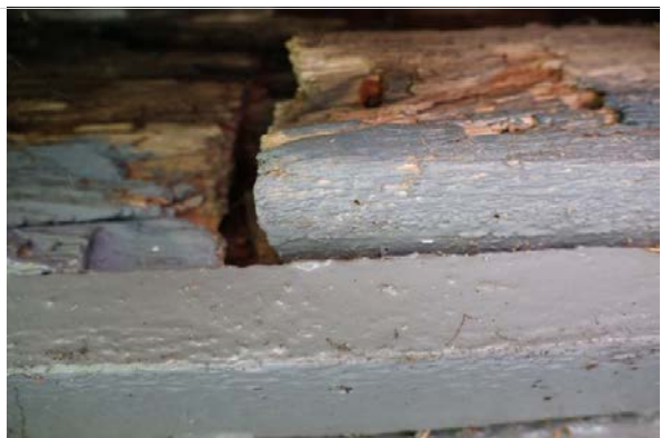
Noen av stokker som er synlig har litt råte.
