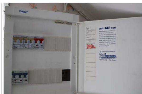
Nyere el-skap med automatsikringer. Bygget er oppført i betong som var vanlig på byggetidspunktet.
