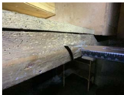
Boreganger etter stripet borebille i skillekonstruksjonen.
