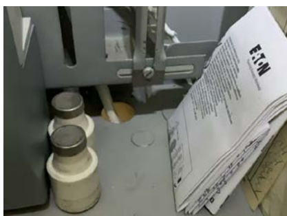
Utlekket gjennomføring i bunn av tavleskap.
