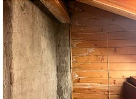
Eldre fuktskjolder loft.
