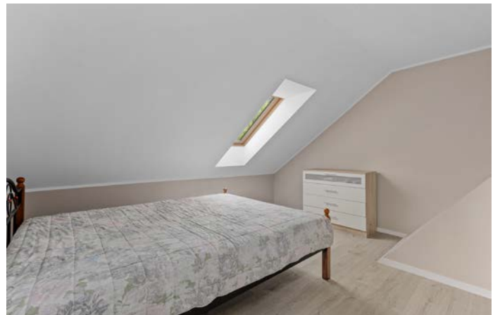
Rom benyttet som soverom (ikke tilfredsstillende rømningsvei)
