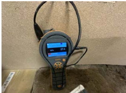
Kryprom - Fuktmåling - Høyt trefukttinnhold / vektprosent ved ventilåpning fra garasjedelen.
