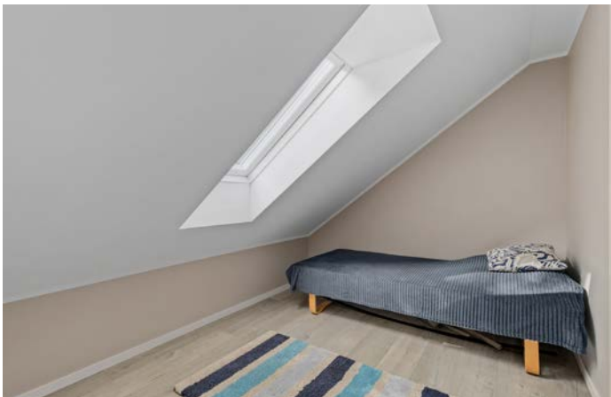
Rom benyttet som soverom (ikke tilfredsstillende rømningsvei)
