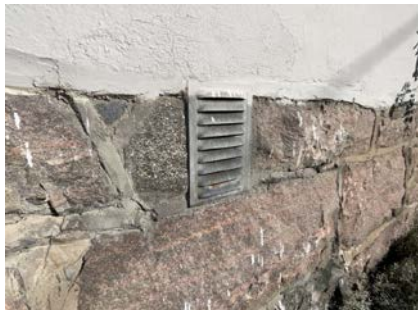
Utvendig lufteventil mot kryprom.
