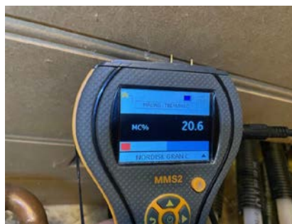
Noe høyt trefuktinnhold / vektprosent i skillekonstruksjonen mot tilstøtende etasje.
