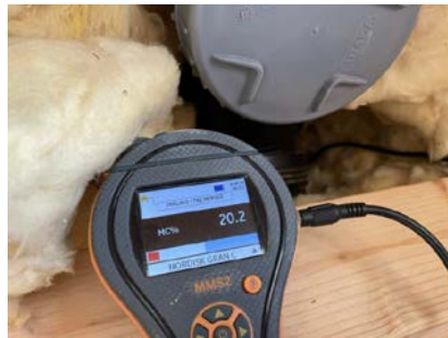
Fuktmåling i skillekonstruksjon ved avløpsgjennomføring mot kryprom. Noe høyt trefukttinnhold / vektprosent i konstruksjonen.
