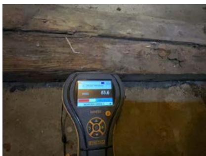
Høyt trefuktinnhold / vektprosent i terskel som ligger mot betonggulv, mot grunnen.
