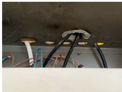
Tavleskap - Underetasje - Utildekkede gjennomføringshull i skapskrog.
