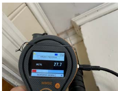
Fuktmåling - Høyt trefukttinnhold / vektprosent ved pipegjennomføring mot kryp loft.
