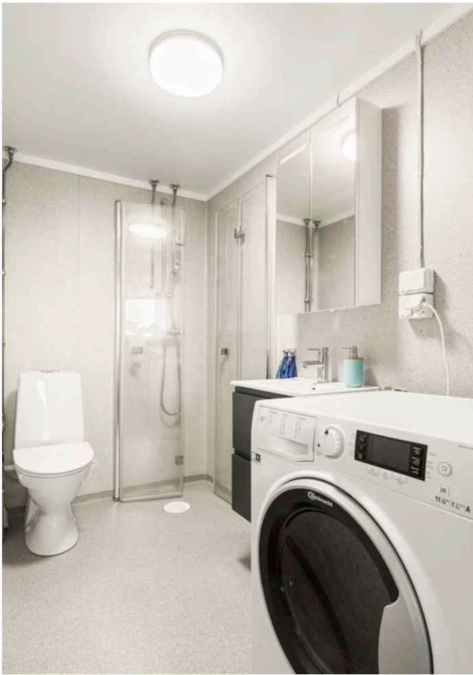
Opplegg til vaskemaskin på badet
