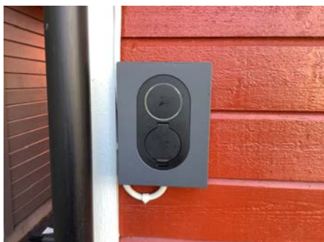
El.bil-lader er montert.
