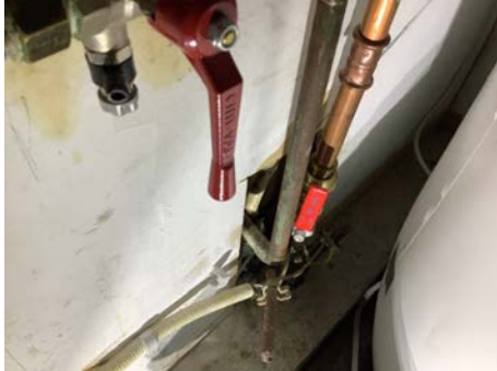
Innvendig stoppekran i kott u/trapp.
