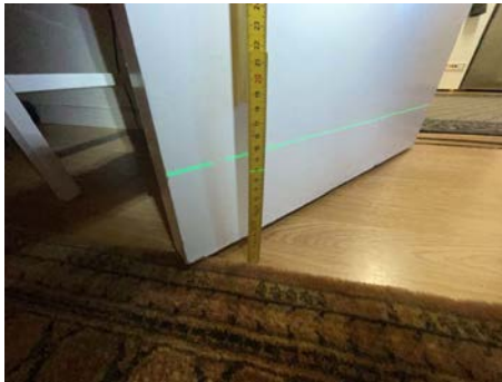
Utkastrek på laser er 11 cm på målestokk. Bilde viser ca. 20 mm høydeforskjell gjennom rommet i gang i underetasjen.
