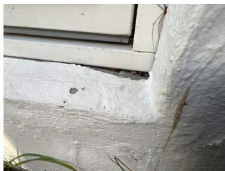
Bilde viser eks. på mangelfull ytre tetting.
