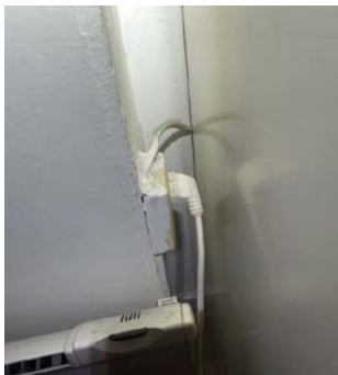
Bilde viser eks. på ikke fagmessig utførelse på kontakt
