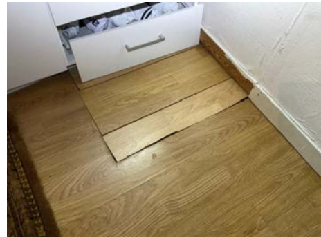
Bilde viser eks. provisorisk lappet gulv.
