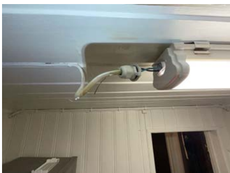
Bilde viser eks. på avvik på tilkoblingpunkt på lysarmatur
