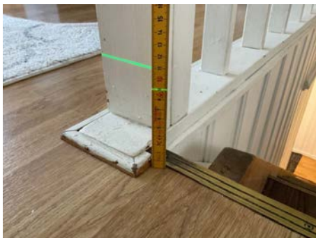
Utkastrek på laser er 11 cm på målestokk. Bilde viser 20 mm høydeforskjell innenfor 2 meter i stue.
