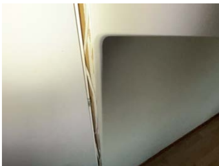
Bilde viser eks. på løse ledninger
