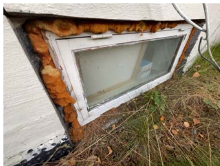
Bilde viser eks. på eldre vindu som ligger noe for lavt mot terreng og uferdig utvendig omramming.
