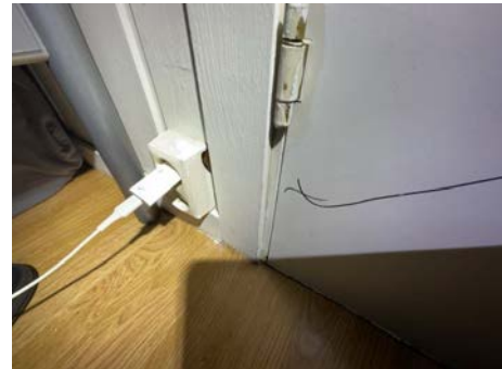
Bilde viser eks. på skadet kontakt deksel.
