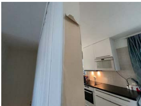
Bilde viser eks. skadet tapet.
