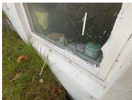
Bilde viser sprekk i glass på eldre vindu.
