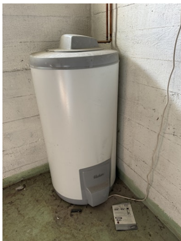
Varmtvannstank i kjeller.
