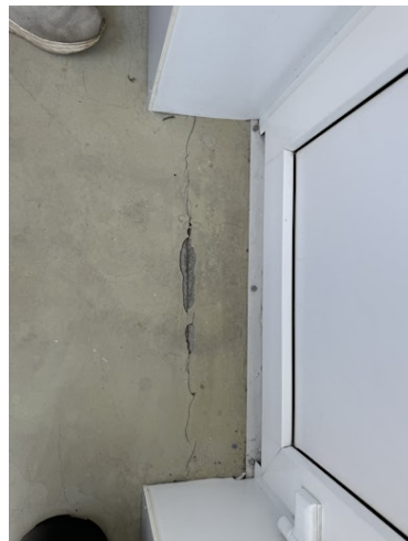
Sprekker i gulvet.
