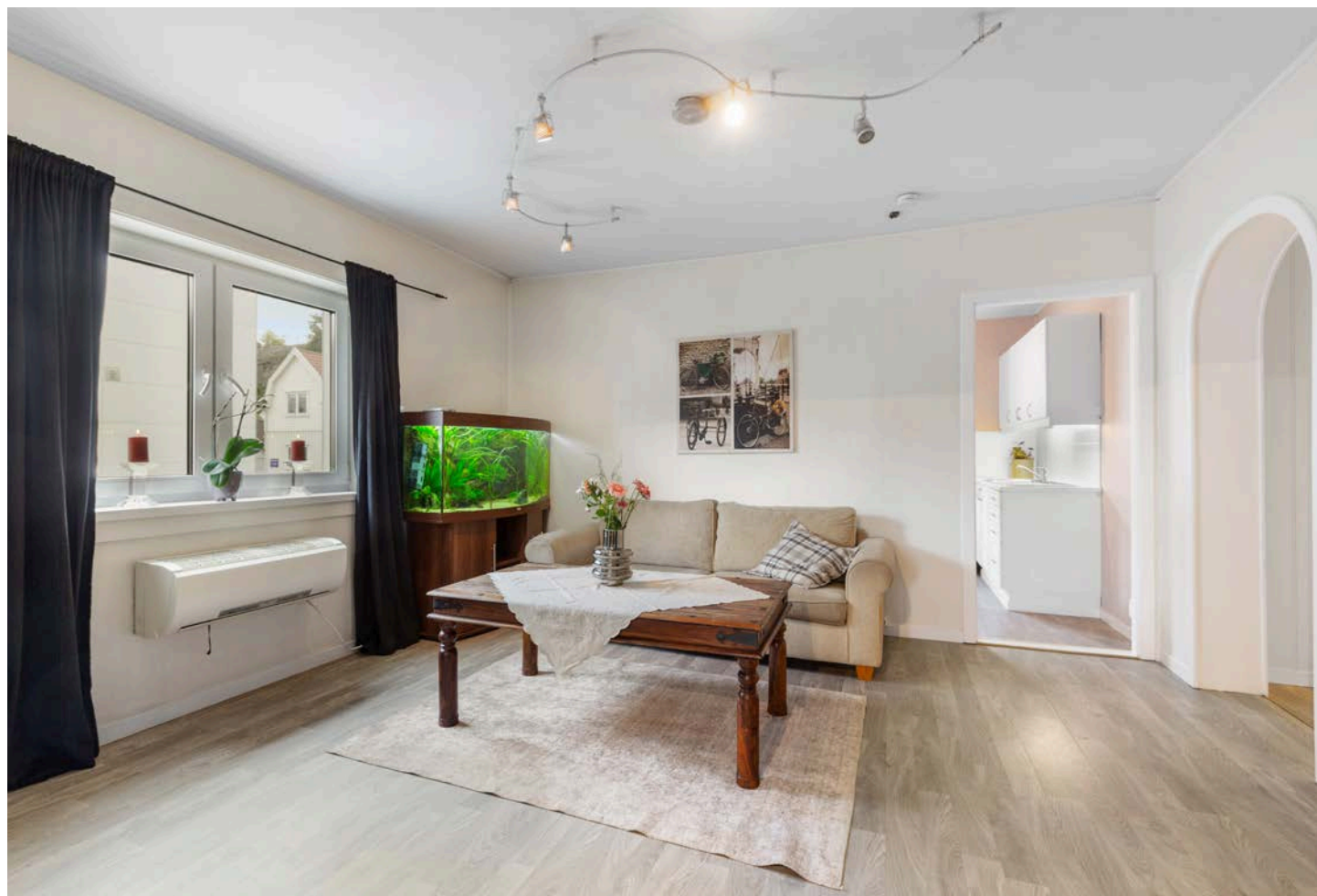
Varmepumpe i stue
