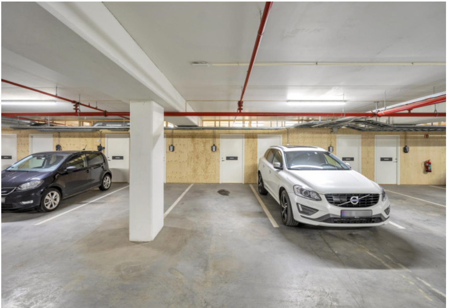
Parkeringsplass i lukket garasjeanlegg. Klargjort til elbillading.
