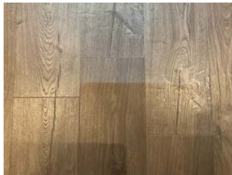
Bilde viser eksempel på overlapper som er mindre enn anbefalt
