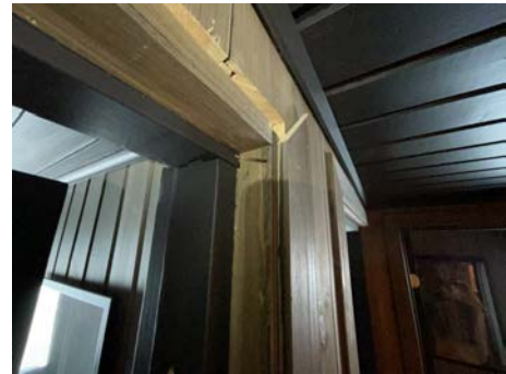
Bilde viser skade på foring.
