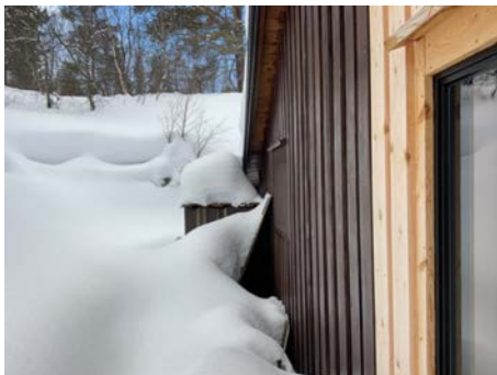
Bilde viser vindusåpning dekket med asfaltplate
