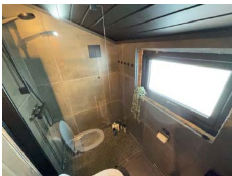
Bilde viser vindu plassert i våtsone, uten vanntette løsninger.
