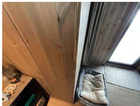
Bilde viser eksempel på ufagmessig ytterhjørne
