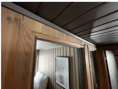
Bilde viser eksempel på manglende listverk
