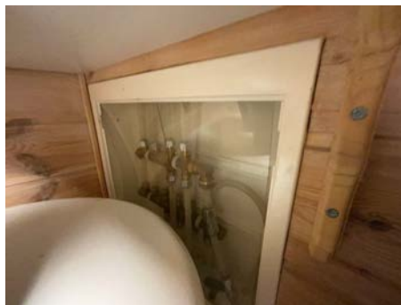
Skap til rør i rør system.
