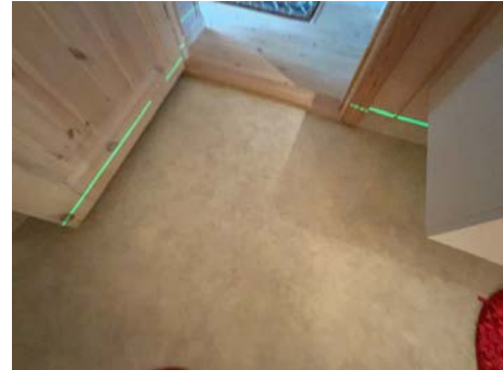
Målt fall på gulv.
