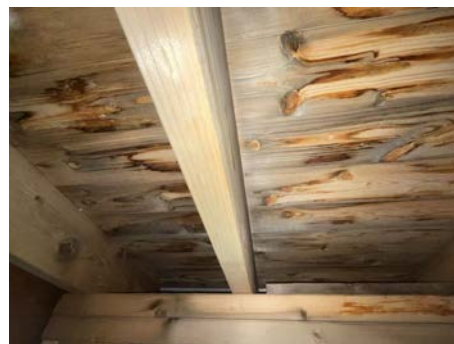
Fuktskjolder i tak på bod.
