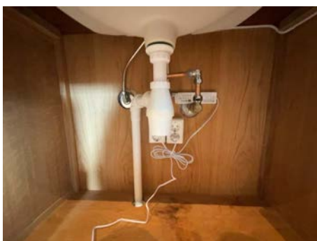
Del av rør til avløp.
