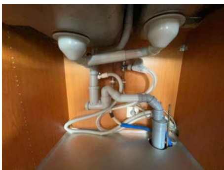
Del av rør til avløp.
