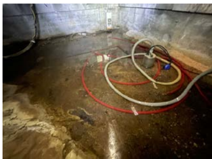
Opphopning av overvann / tilsigsvann på den nordvestlige siden.
