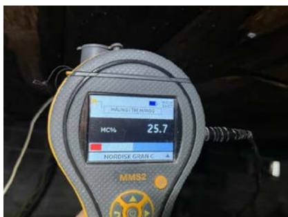
Skadelig høyt trefukttinnhold / vektprosent i skillekonstruksjonen.
