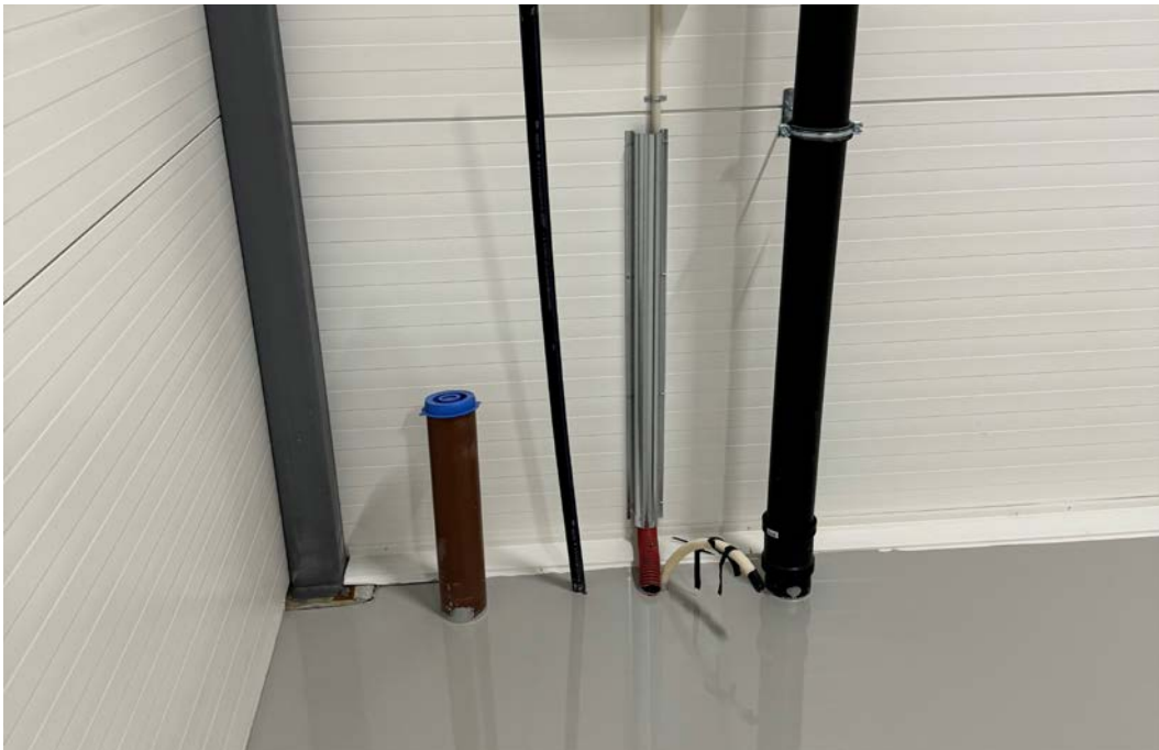
Tilrettelagt med strøm til ska, lys og mulighet for toalett - Epoxy på gulv
