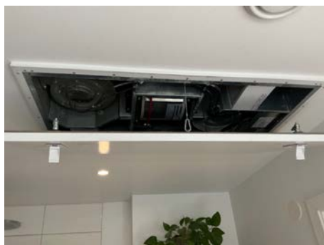
Motor plassering i himling på badrom
