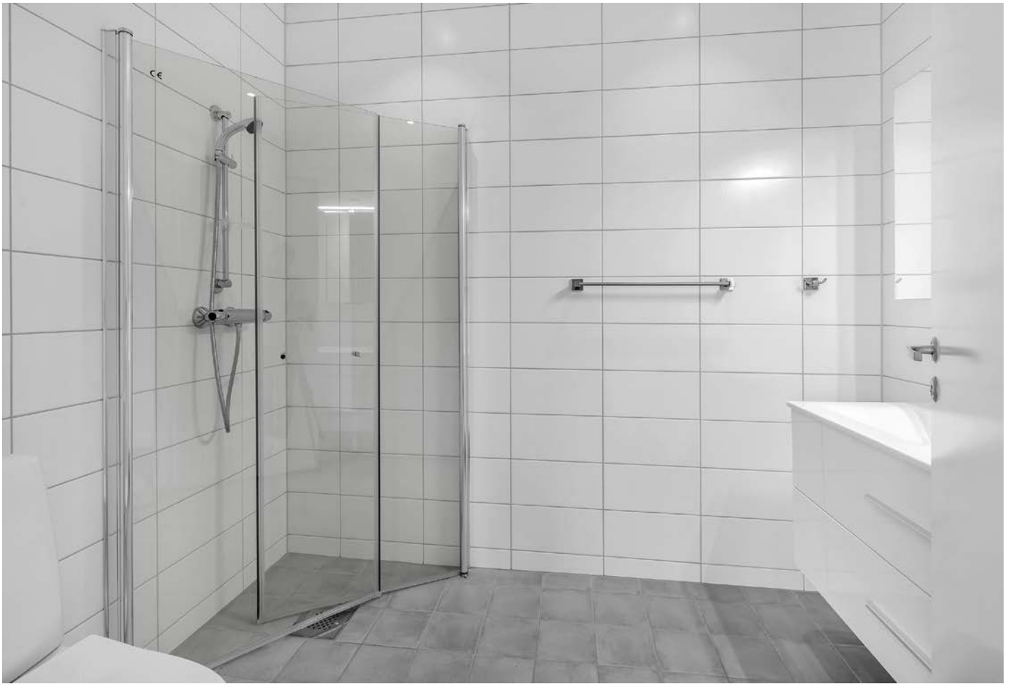
Bad nr. 1 utstyrt med dusj, toalett og servant med skap
