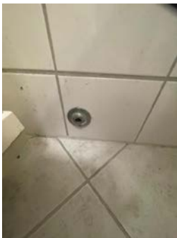
Drenering i vegg for synliggjøring av lekkasjevann.
