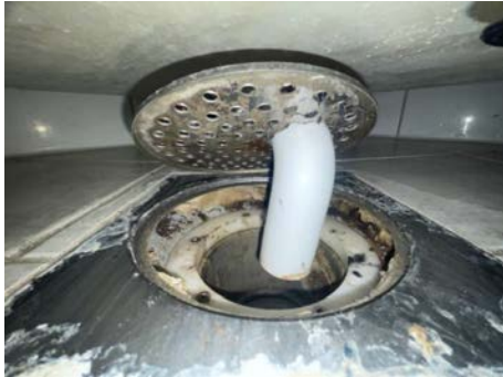
Sluk under dusjkabinett.
