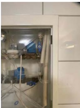
Stoppekraner og vannstoppersystem.
