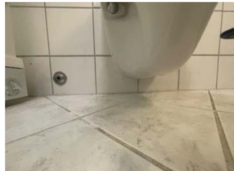
Manglende hull for synliggjøring av innebygget sisterner. Drenering dra vannfordelerskap.
